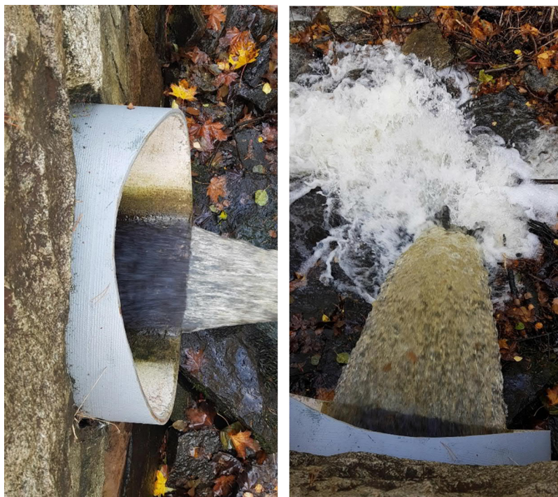
Figur 3. Flöde genom kulvert nedströms Kvarnsjöns utloppet före (vänster) och efter (höger) att utloppet rensats på grenar, kvistar och en stock. Foto: Nacka kommun
